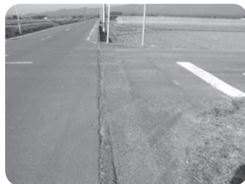
補修を必要とする町道平松植木線
