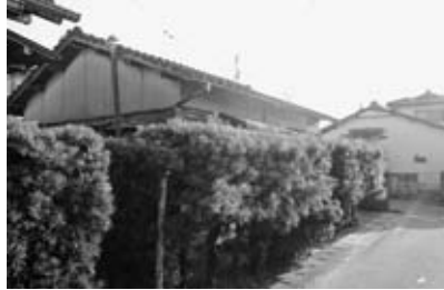
大丈夫？町営住宅耐震性
