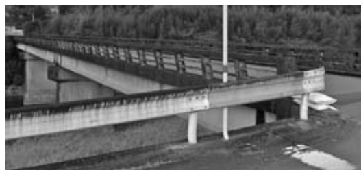
補修予定の天子橋(牛島)
