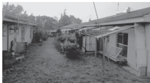
建て替え時期がきている町営住宅
