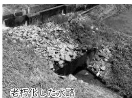
老朽化した水路
