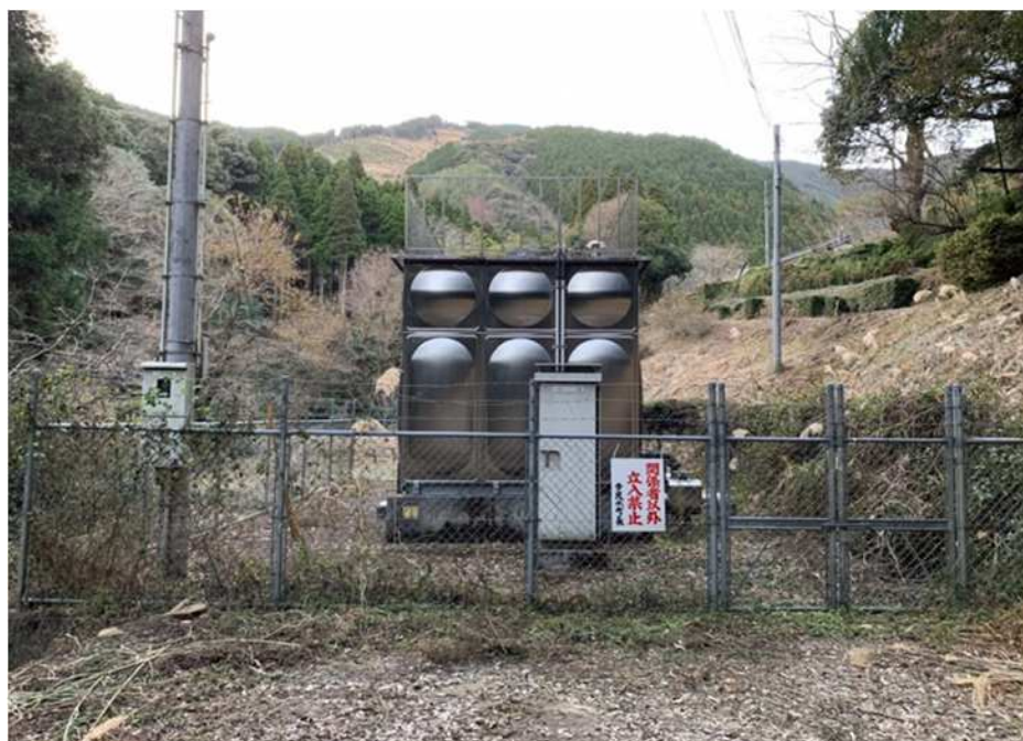
【 宮ヶ野配水池 】
