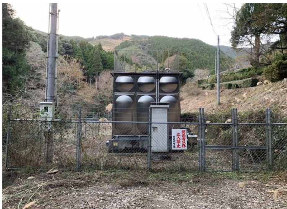
【宮ヶ野配水池】
